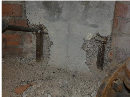
Traitement anti corrosion des fers et rebouchage des fissures de la structure
